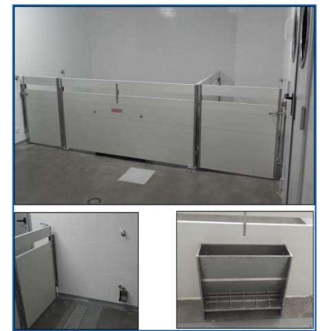
SALA DE CERDOS:
